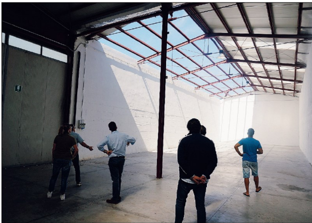
Un sopralluogo a Porto Viro nei giorni successivi al nubifragio del 10 agosto 2017
